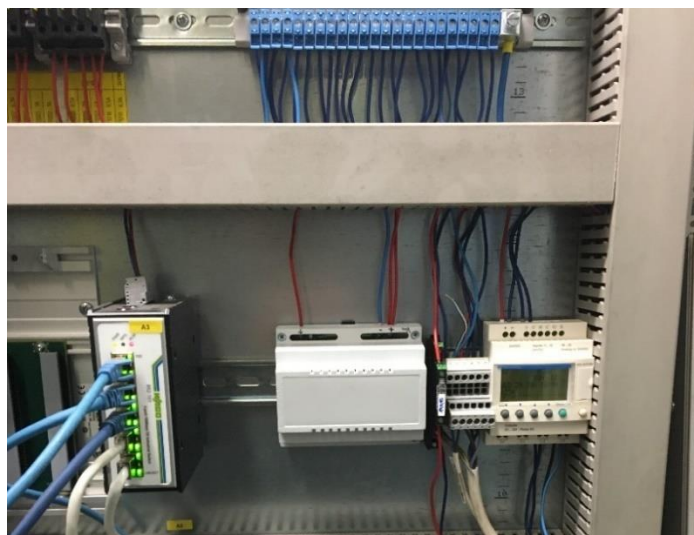
Obrázek 12 – Arduino v rozvodné skříni [zdroj: autor]
